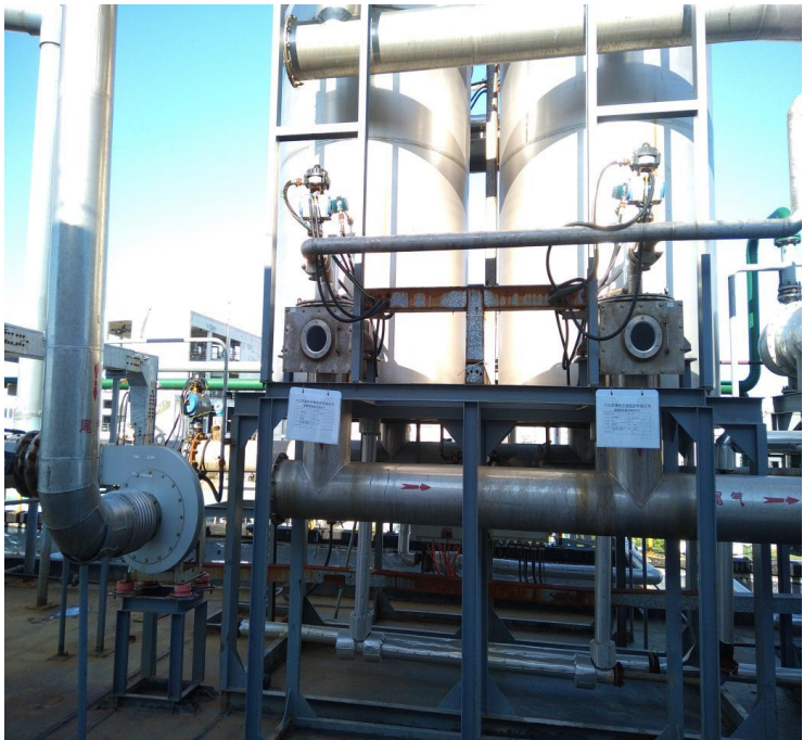
改造后的氯醚回收装置
