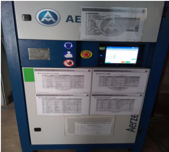
改造后空气悬浮风机
