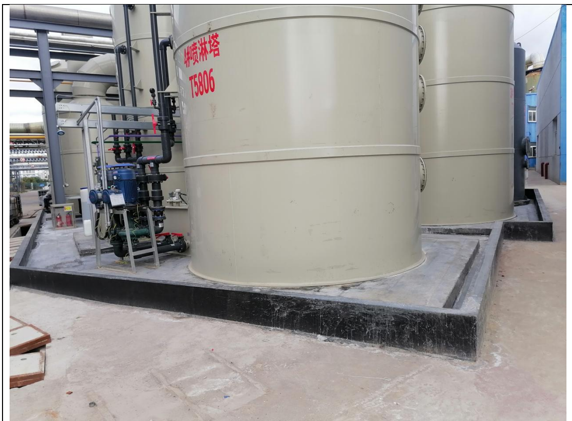
三废处理区：废水处理设施上方均已加盖，废气处理设施已设置围堰，地面完好无明显破损裂痕。
